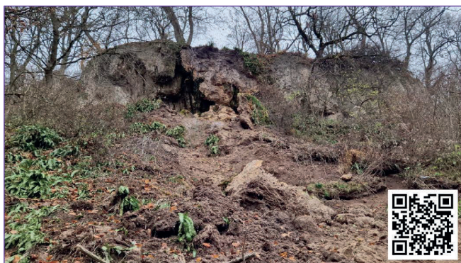
Рис. 4. Загальний вигляд скелі після обвалу (11.11.2024)
